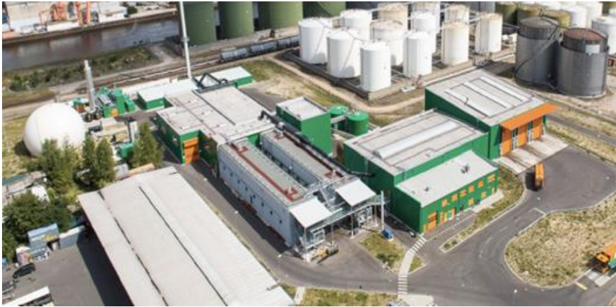
图 7：垃圾处理设施，左上角为沼气净化提纯厂（来源：柏林城市清洁公司）
