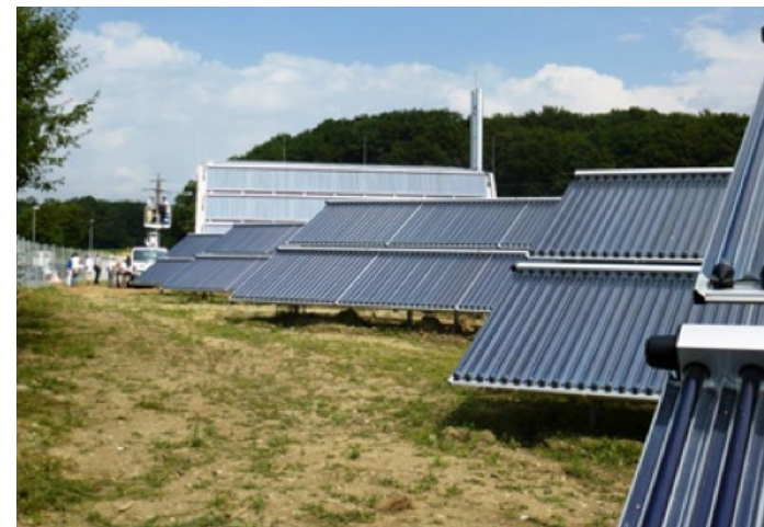
图38：布辛根（Büdingen）集热站的真空管集热器
