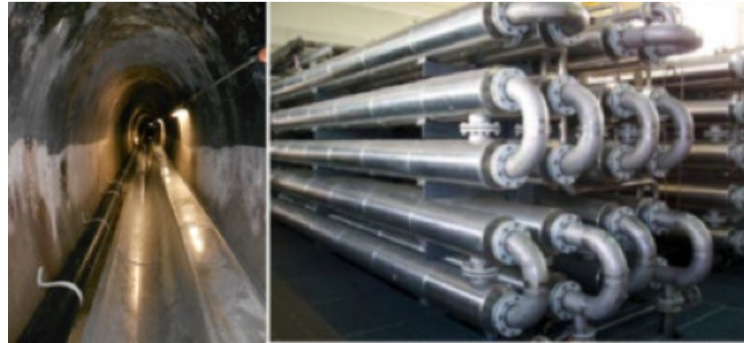
图24：排污明渠热交换器（左）和旁路热交换器（右）
