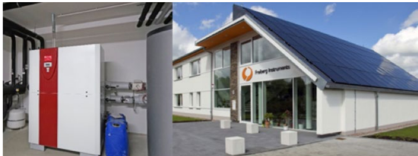
图19: Freiberg Instruments 公司总部——办公楼的空间供热和空间制冷
