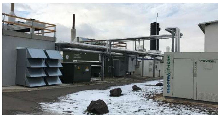
图 8: Grabsleben村沼气厂的热电联产机组（左）ORC机组及沼气净化提纯装置（右中/右上）
