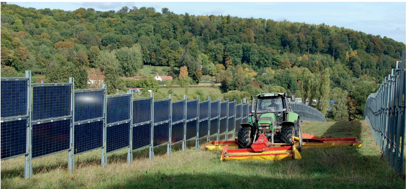
图 31：萨尔州埃佩尔博恩-迪尔明根光伏园区内的垂直双面光伏组件，输出功率为 2MWp，建设方是 Next2Sun 公司 © Next2Sun GmbH
